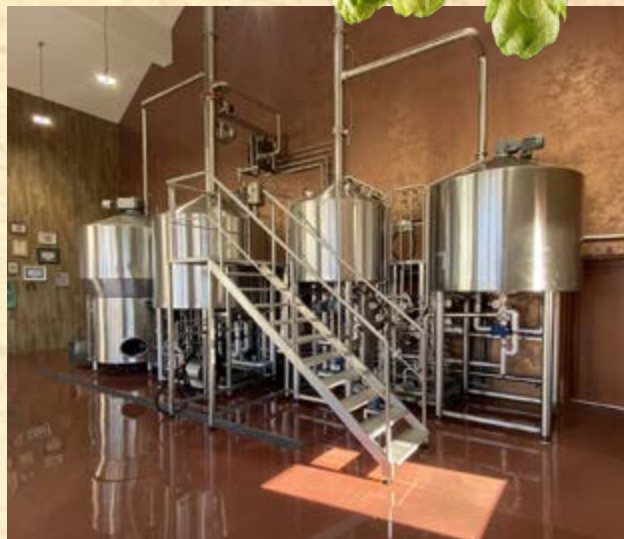
Nynější 5 nádobová varna 20 hl instalace 2023
